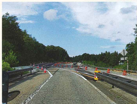
能登半島を縦断する基幹道路である「のと里山海道」は迂回箇所や舗装修復箇所の連続
